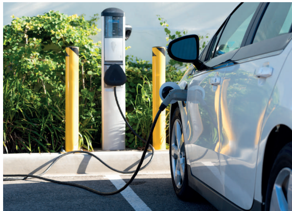
Borne de recharge électrique
